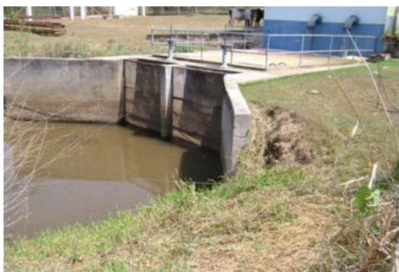
Figura 7 – Entrada Poço de Sucção
