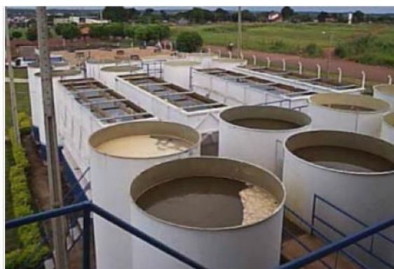
Figura 10 – Vista Superior da ETA
