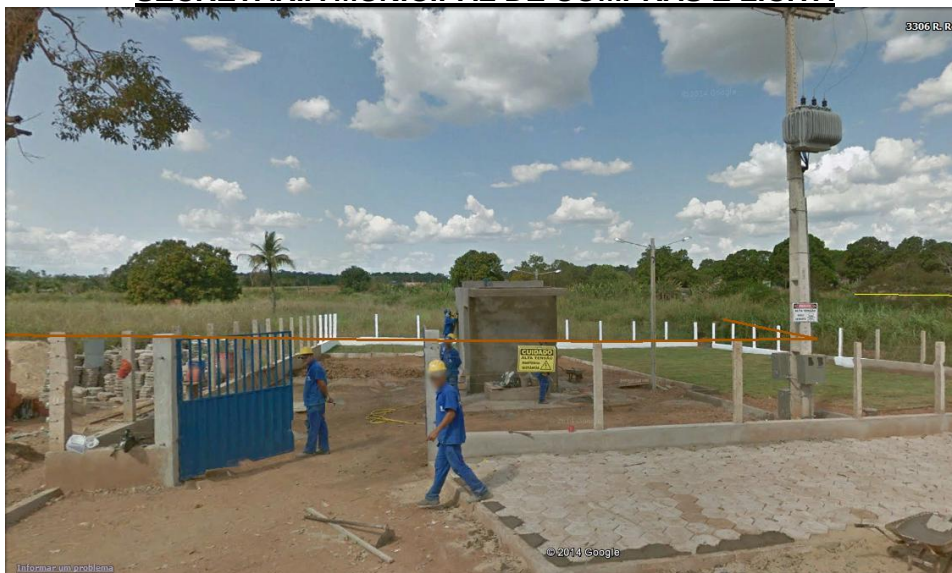
Figura 32 – Estação Elevatória de Esgoto
