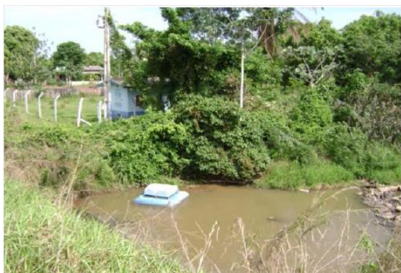
Figura 19 – Captação e EEAB
